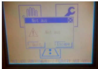
Armoire sous tension
